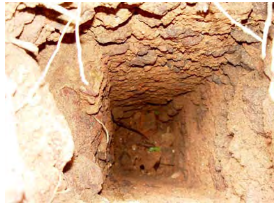
Figura 10 - Lacuna deixada no alicerce pela desintegração da madeira do esteio.
